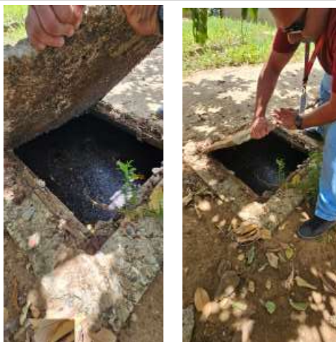
Figura 11 – Tanque Séptico Cheio
